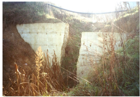
Figura 2 muro a retta spezzato dal movimento franoso
