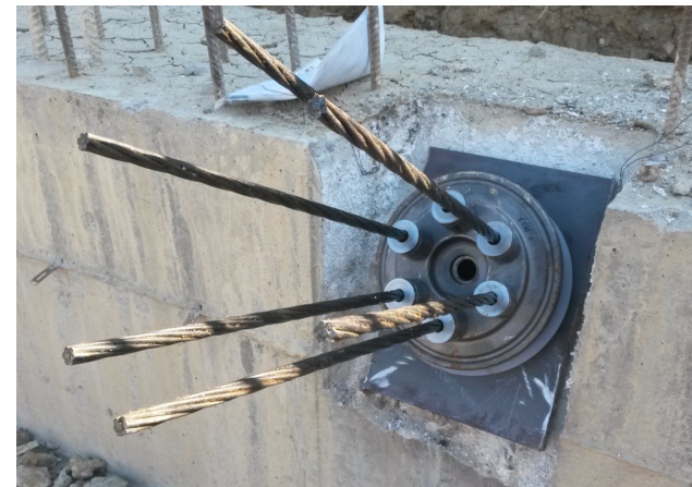
Particolare trefoli e piastra (Tiranti di testata)
