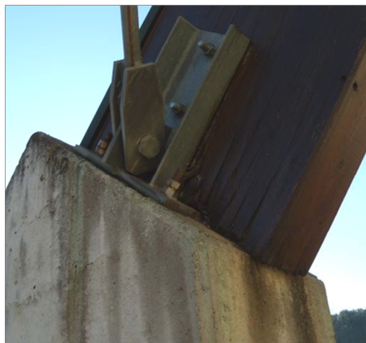
Effetto del degrado del legno con conseguente punzonamento della testata del puntone
